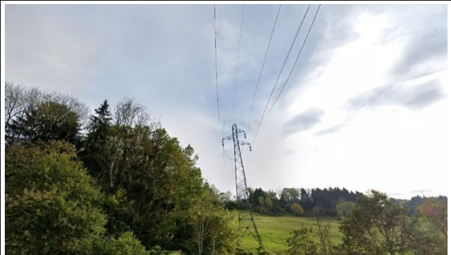
Ligne électrique de 400 kV passant à l'ouest du site.
